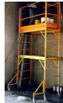
Andamio con estructura adicional
